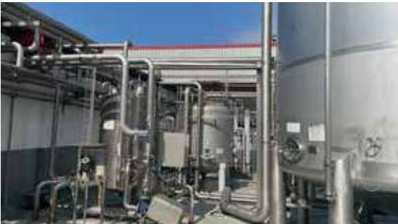
Récupération des eaux de pluie
