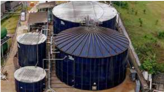
Traitement des eaux usées pour l'usage industriel tel que la sécurité incendie
